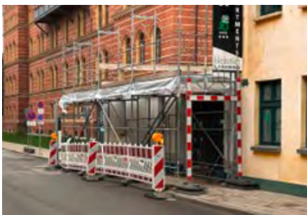
Absperrschranken als Durchgangsrahmen mit Aufstellvorrichtungen vor dem Gerüst aufgestellt Fotos: Langer, BG BAU
