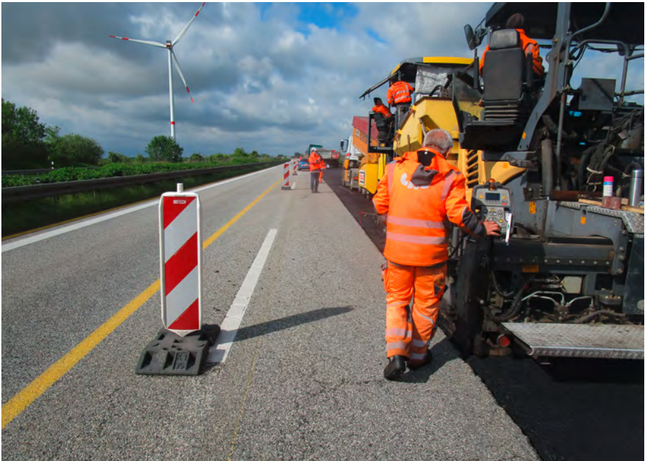
Messen der Mindestbreite des Arbeitsplatzes und des seitlichen Sicherheitsabstands beim Einbau der Deckschicht Foto: Langer, BG BAU
