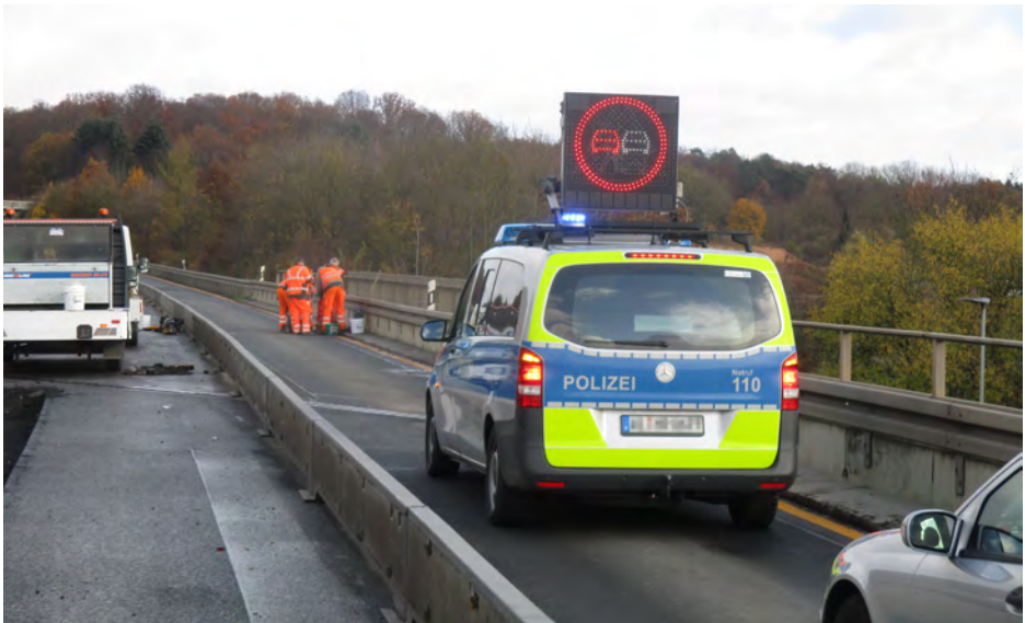
Kurzzeitige Sperrung einer Fahrbahn im Baustellenbereich durch die Polizei. Foto: Haardt, BG BAU
