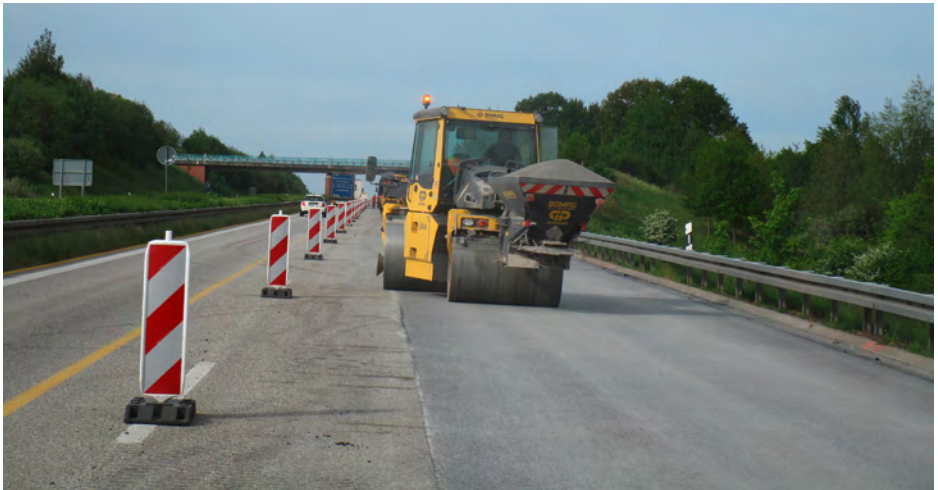
Walze im Hundegang Foto: Langer, BG BAU
