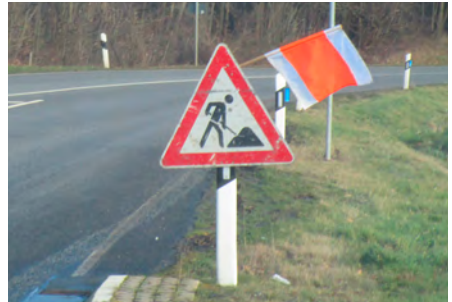
Unzulässige Montage der VZ an einem Leitpfosten. Die Aufstellhöhe, Standsicherheit und der Abstand zur Fahrbahn sind nicht gewährleistet. Foto: Haardt, BG BAU
